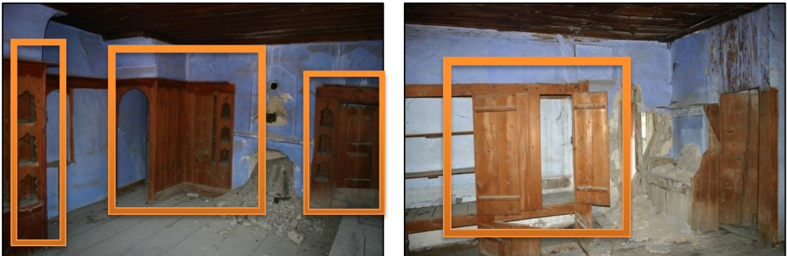
Şekil.107. Yapının Mevcut Halinden Alınıp Onarılarak Kullanılabilecek Elemanlar
