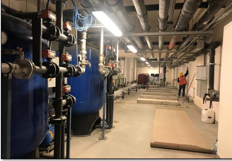
Şekil 11. Yalıtılmış Mekanik Kanallar (Araştırmacı, 2018)
