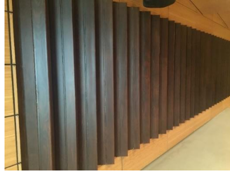
Şekil 15. Ahşap Yansıtıcı Duvar Panelleri
