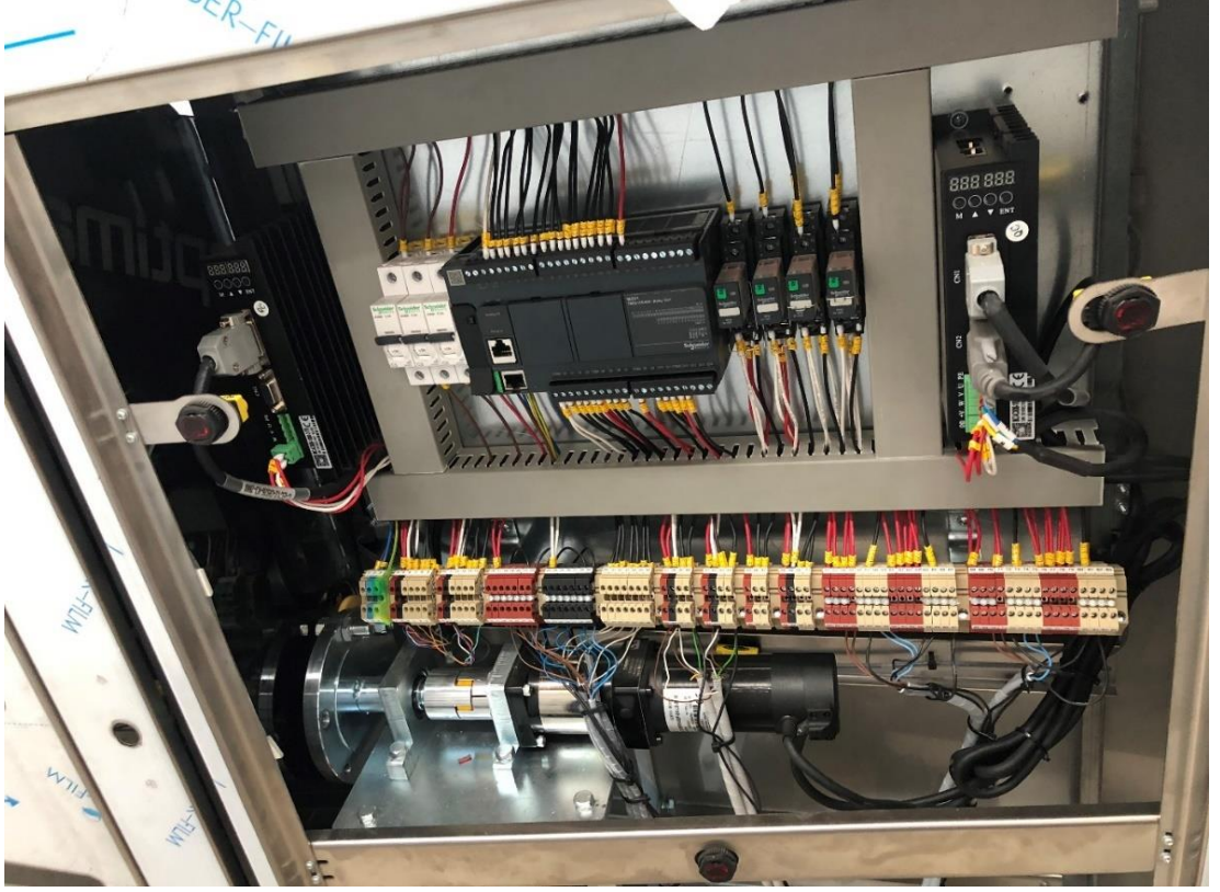
Şekil 3.6: PLC-Servo Motorlu Tasarım Elektronik Yapı
