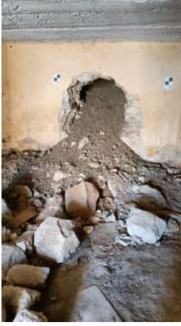
Şekil 5.4. Bodrum katta define arayanların yapıya vermiş olduğu tahribat
