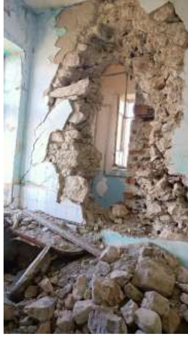
Şekil 5.5. Zemin katta mutfak-wc arasındaki duvara verilen tahribat
