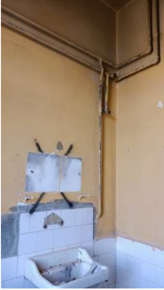
Şekil 4.9. Konağın temiz su tesisatı boruları
