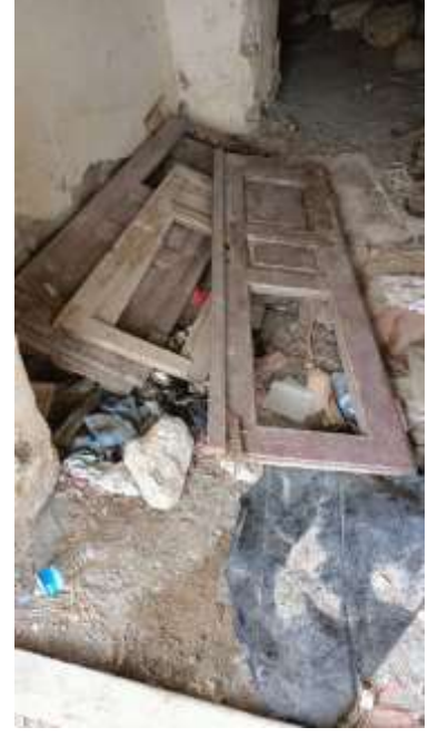
Şekil 5.6. Yapının kapılarının sökülüp atılmasına örnek
