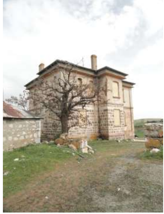
Şekil 5.8. Güney ve batı cephesinde yonga levhalar ile kapatılan açıklıklar (05.05.2021)
