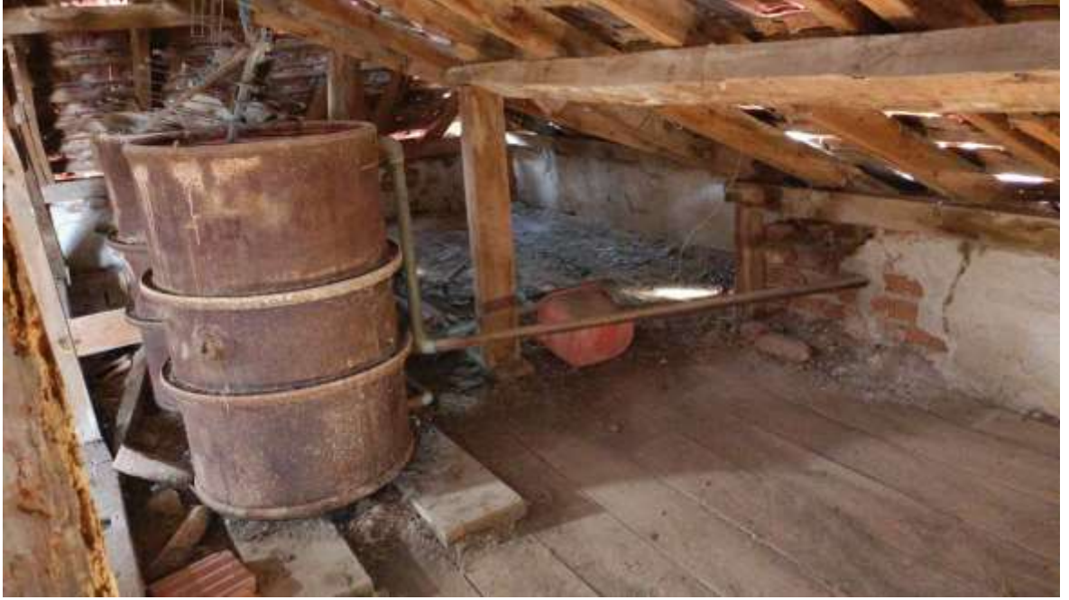
Şekil 4.8. Çatı katında bulunan iki adet su tesisatı varilleri
