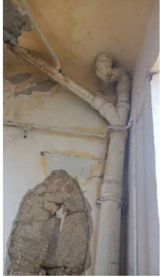
Şekil 4.10. Konağın pis su tesisatı boruları
