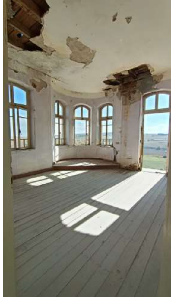
Şekil 5.2. Çatıdaki çökmeler sebebiyle yapının içerisindeki hasar
